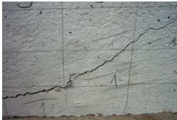
Figure 3.13a : Fissuration de la poutre 1 à la rupture
