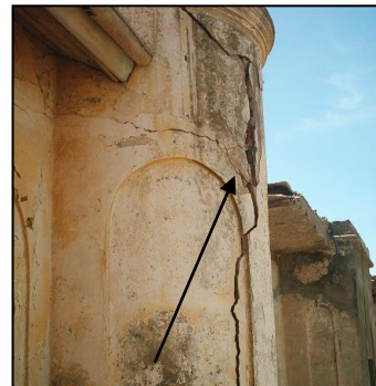
Figure2-3:Tracé d'une fissure
