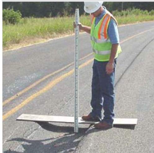
Figure 1.3 : Exemple de chaussée atteinte d'orniérage (Bahssem, 2006)
